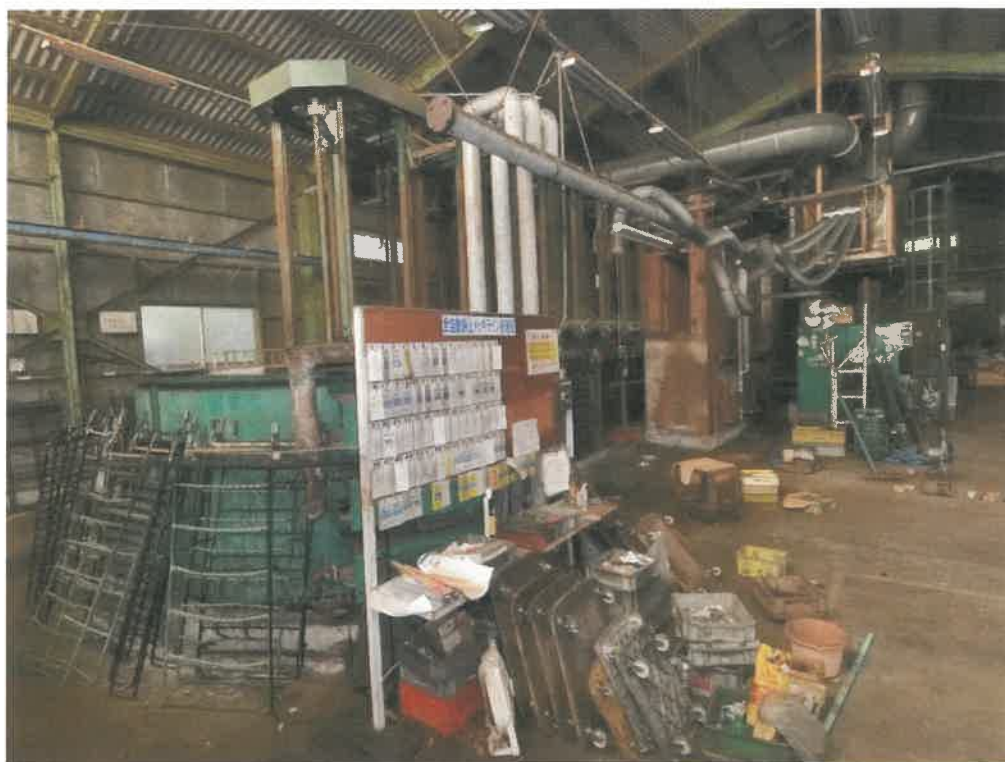
19 物件9主建物に設置された機械類 (④静止メッキライン)
