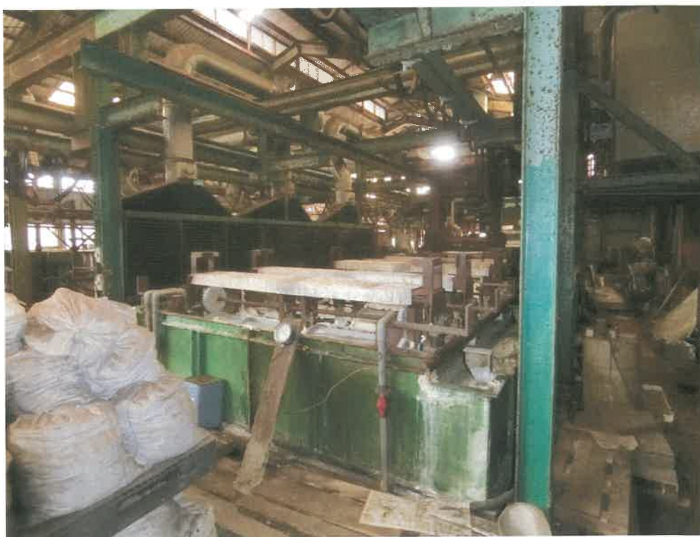
1 8 物件 9 主建物に設置された機械類（③回転メッキライン）
