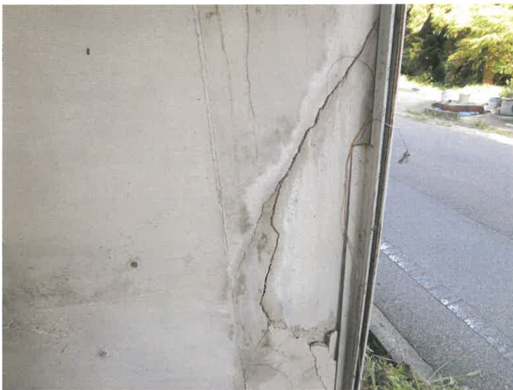
3 4 物件 1 0 附属建物 5 内部の状況（車庫壁面のクラック）
