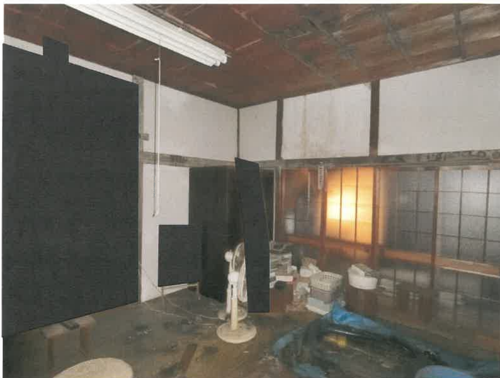
2 5 物件 1 0 主建物内部の状況（天井及び床面の損傷（和室 1））
