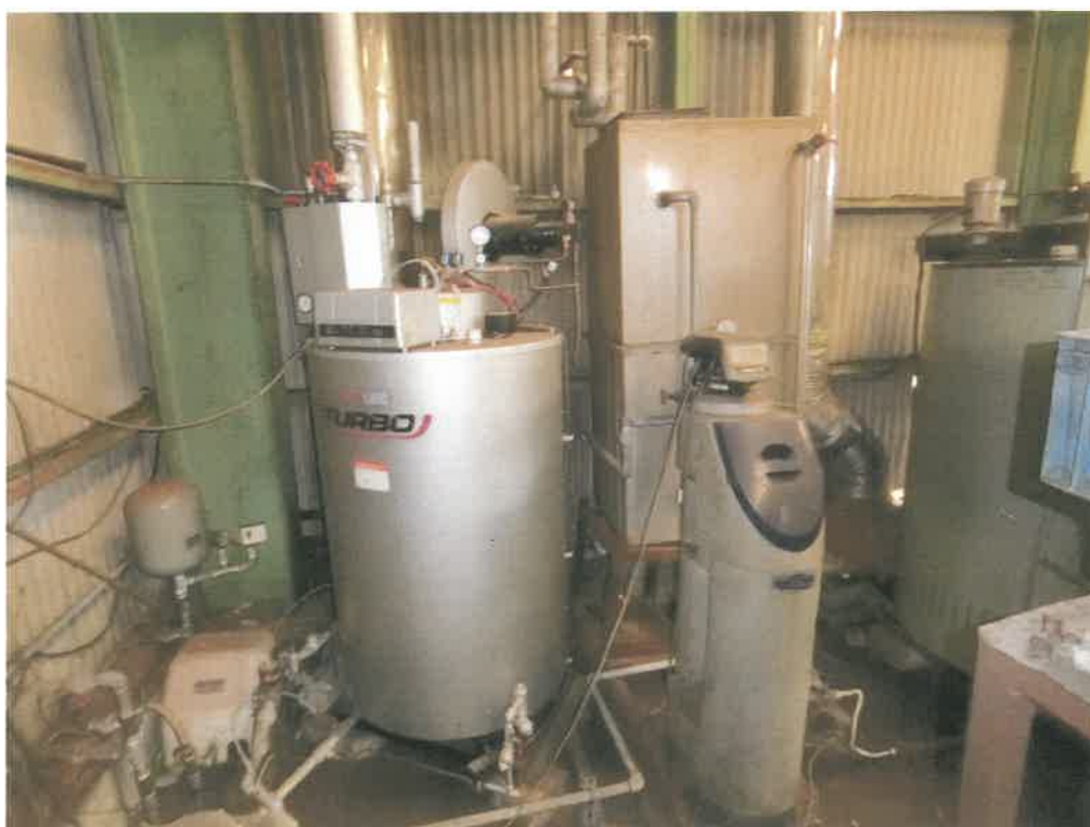
20 物件9主建物に設置された機械類 (⑩⑪⑫スチームボイラーほか)
