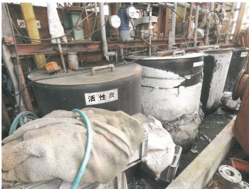
2 2 物件 9 主建物に設置された機械類 (⑯廃棄物タンク)
