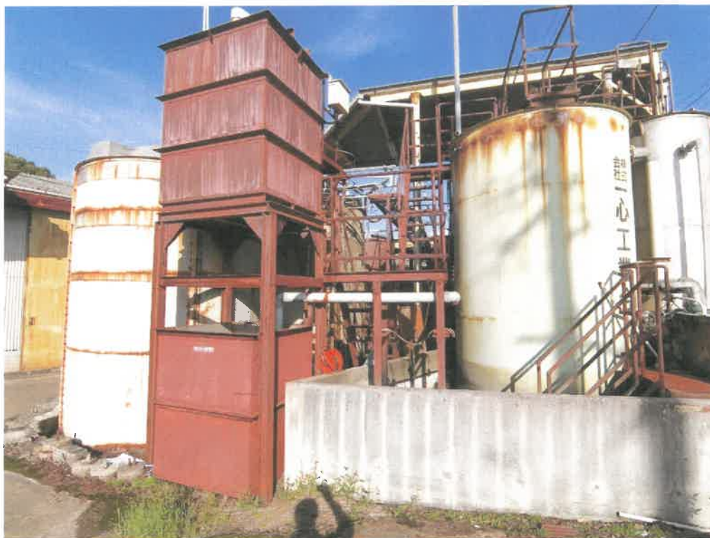
2 1 物件 9 主建物に設置された機械類 (⑬⑭⑮貯水タンクほか)
