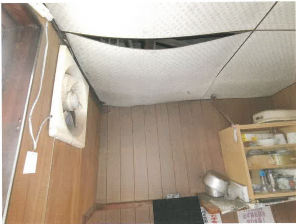
1 6 物件9 主建物内部の状況（天井の損傷（事務室1））
