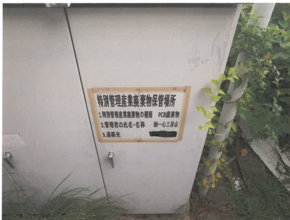
2 3 物件 9 主建物南東側に設置された特別管理産業廃棄物保管所
