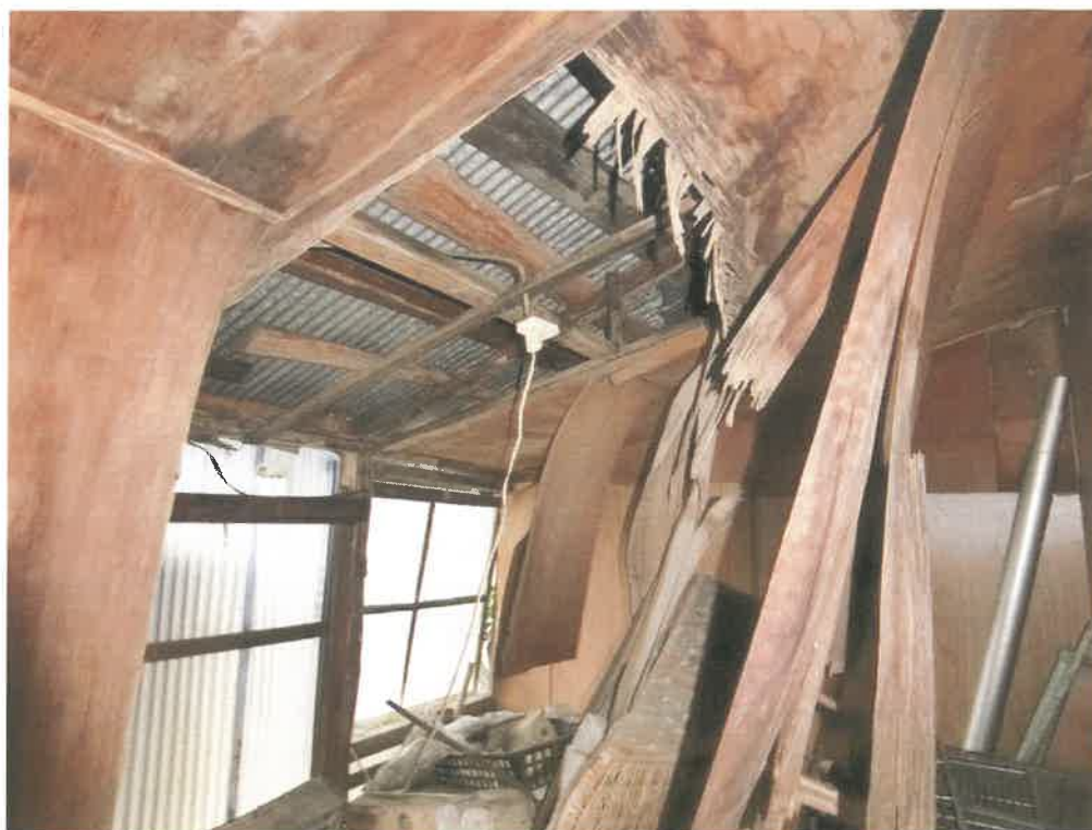
27 物件10附属建物1内部の状況(天井の損傷(和室1北西側の土間))
