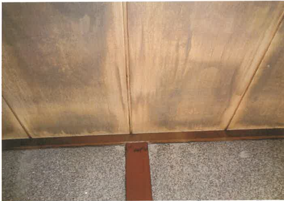
⑦ 屋内の状況 物件3建物 広縁 天井の雨漏り跡
