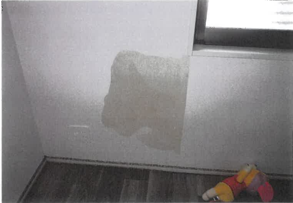
⑨ 壁紙クロスの剥離箇所
