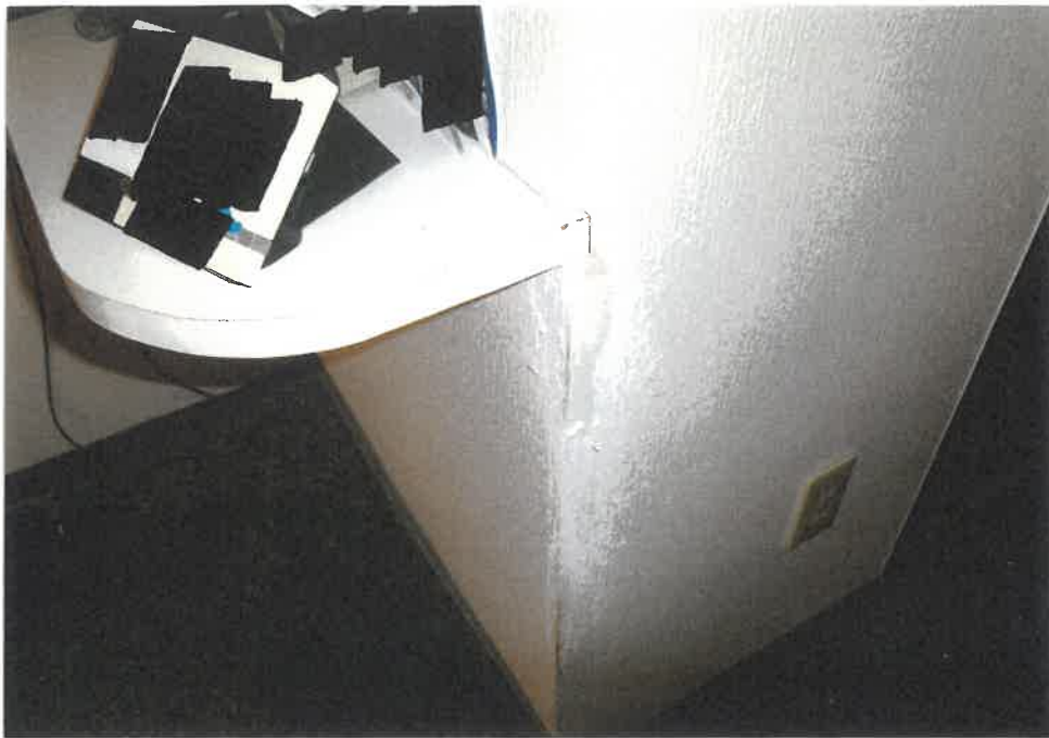
⑤屋内の状況 居間の壁の 状況
