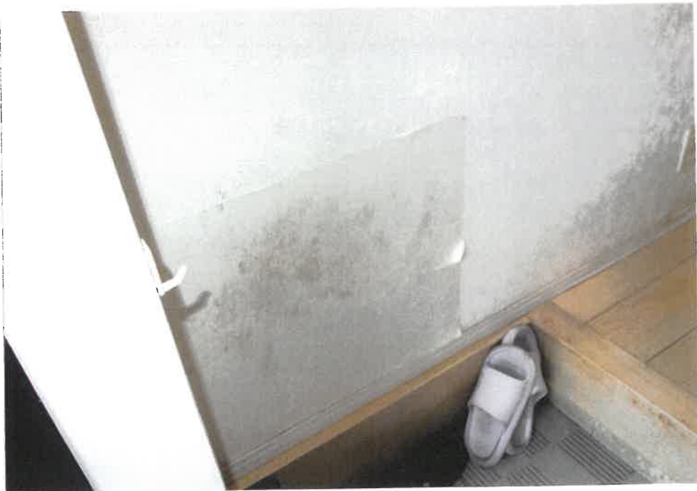
⑥ 壁面の補修跡（玄関）
