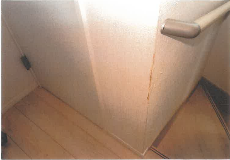
⑦ 壁面の損傷状況（2階階段）
