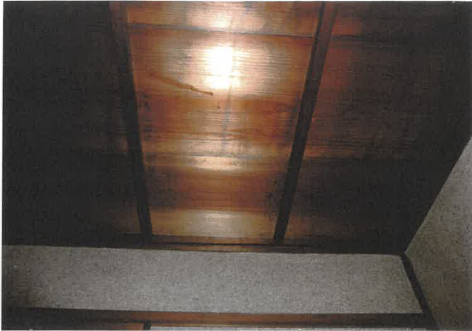
⑨屋内の状況 和室 1 の天井 の状況 (物件 4) (主である 建物)
