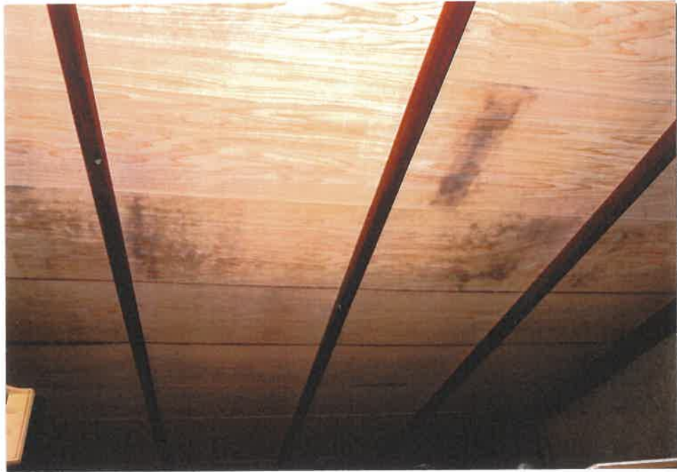
⑬ 雨漏りが原因と思われるしみ跡（和室5）
