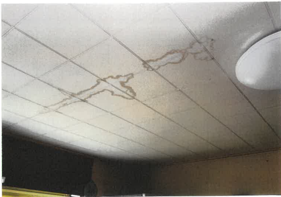
⑫ 雨漏りが原因と思われるしみ跡（キッチン）
