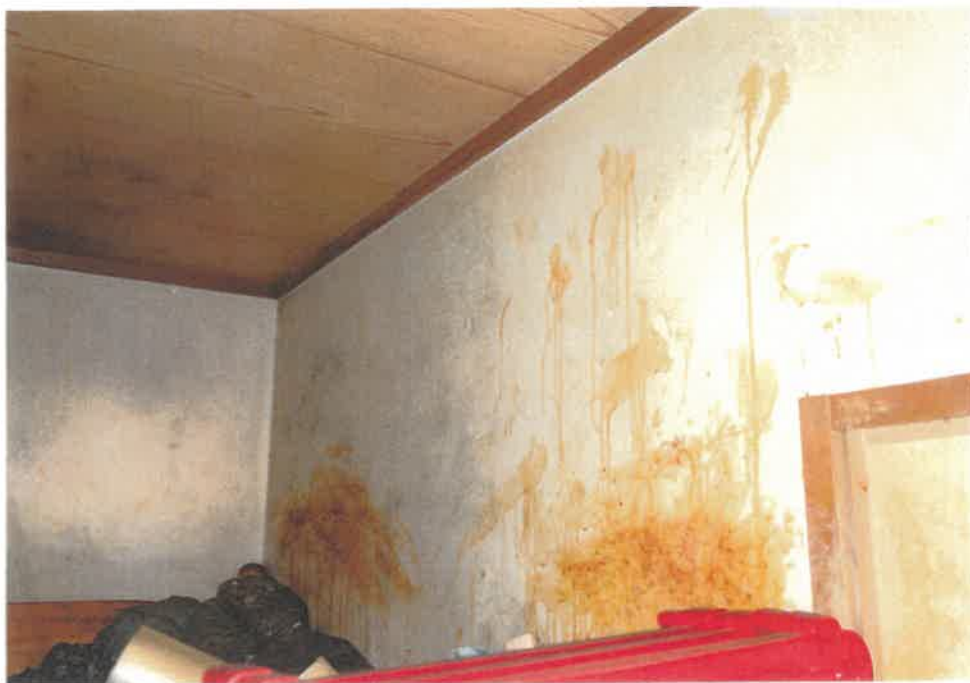
⑦ 壁紙クロスの汚損状況
