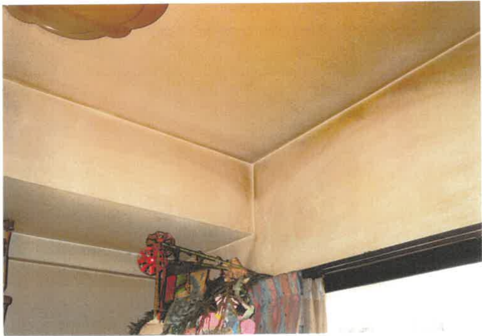
⑥ 壁紙クロスの汚損状況
