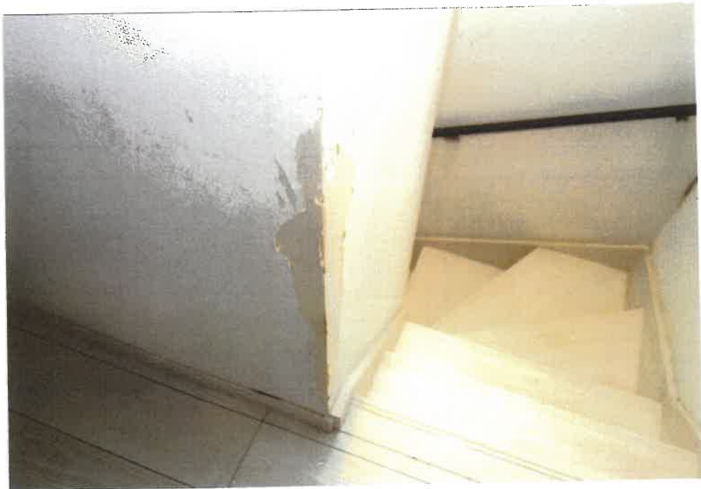
⑧ 壁面の損傷状況
