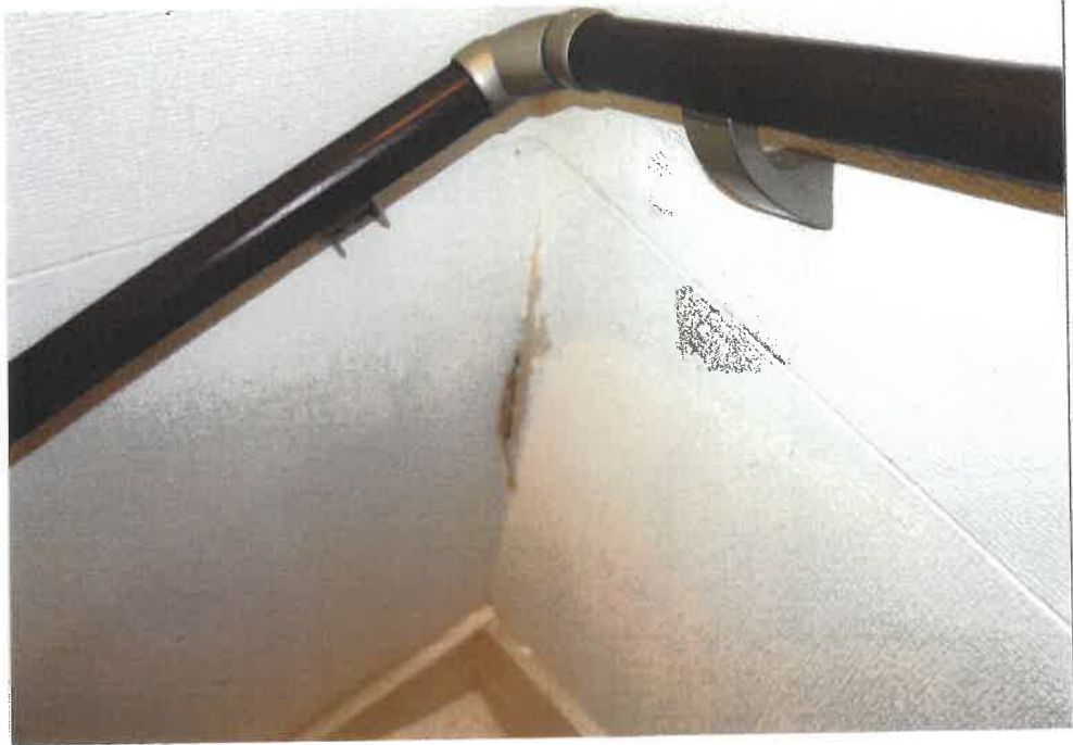
⑦ 壁面の損傷状況
