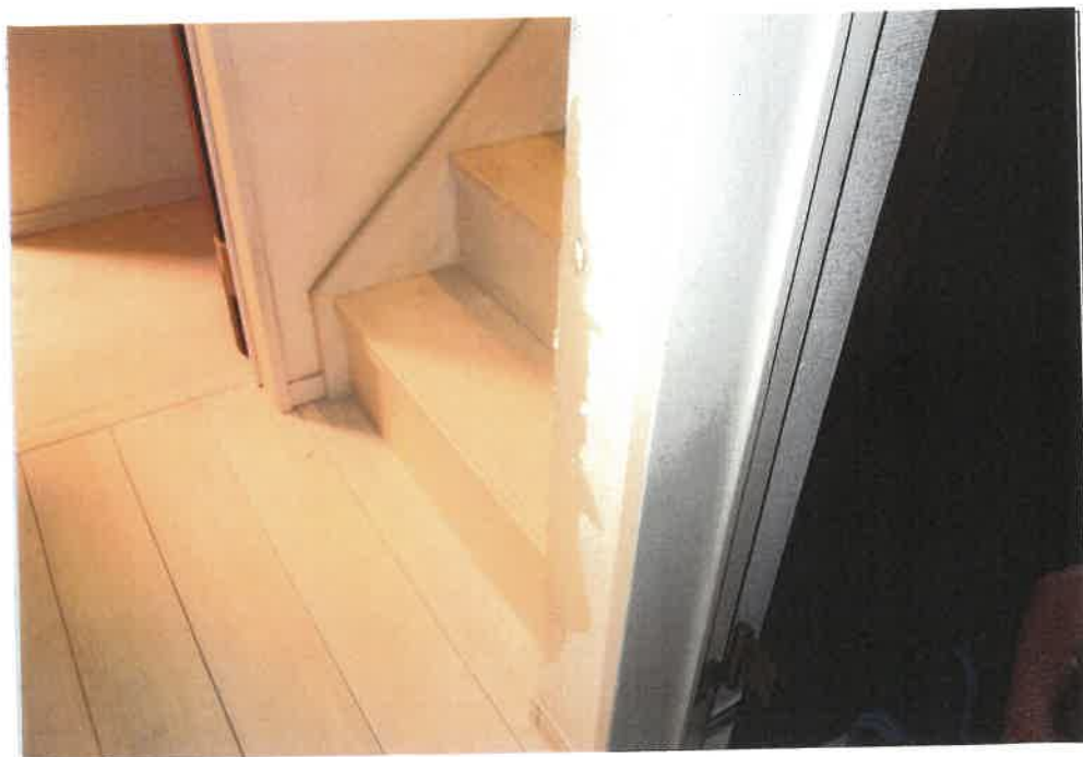
⑥ 壁面の損傷状況
