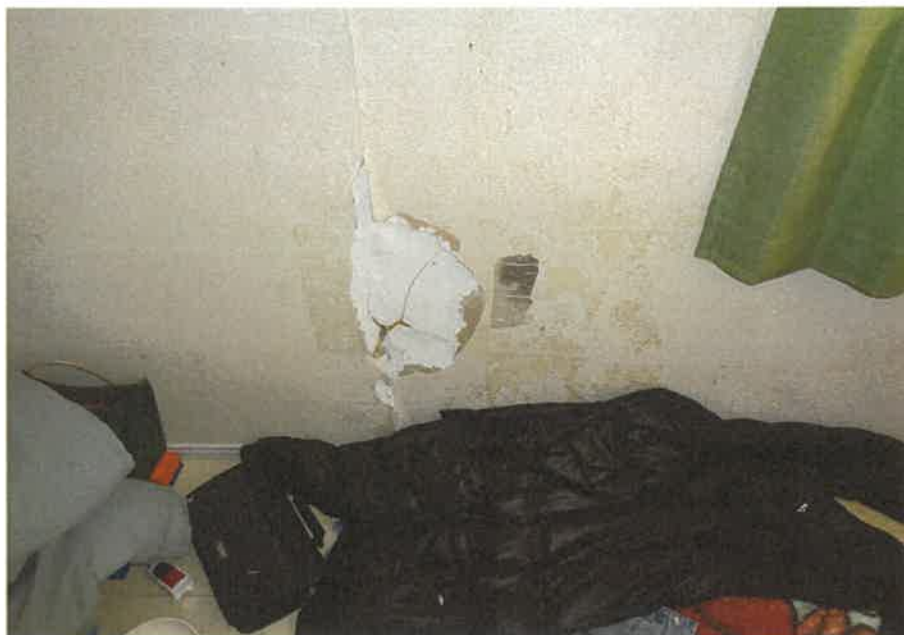
屋内の状況 LDK 壁の破損等
