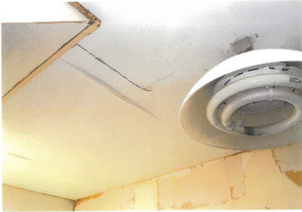
⑬ 壁紙クロスのひび割れ
