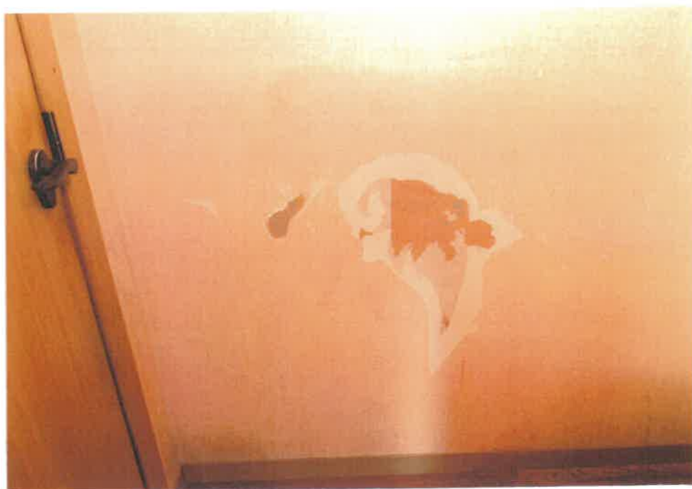
⑩ 壁紙クロスの剥離
