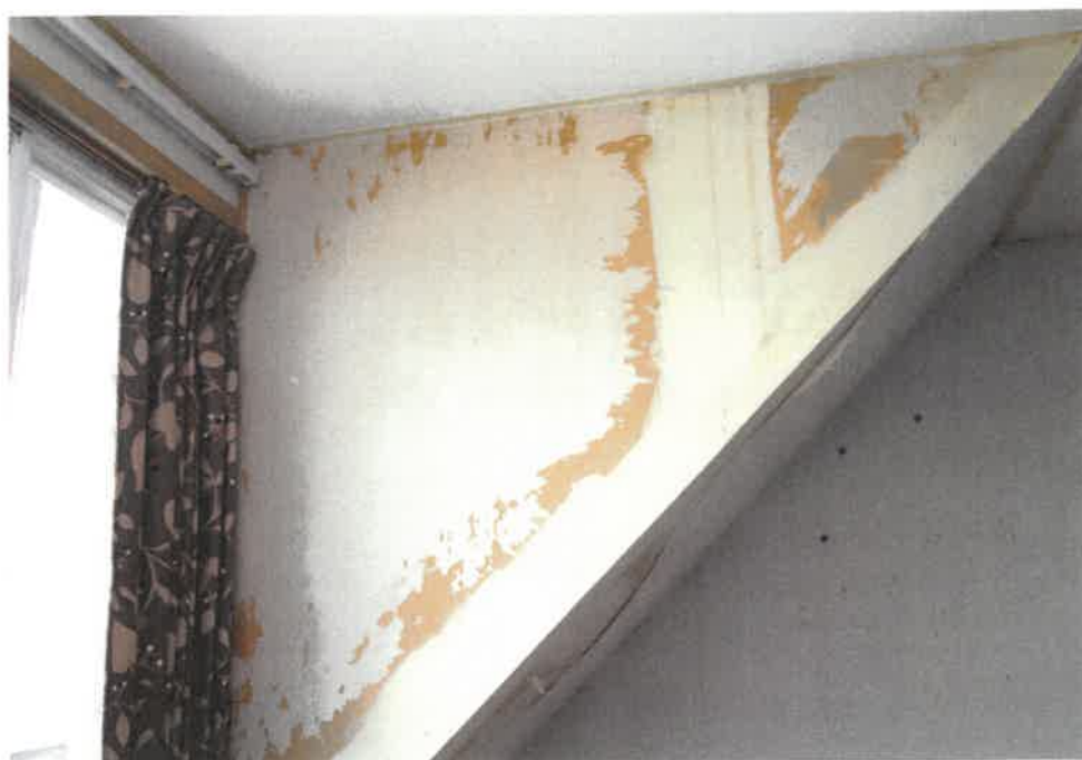
⑫ 壁紙クロスの剥離
