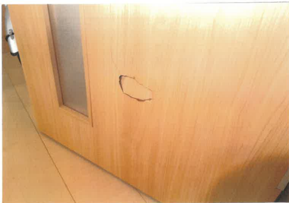
⑥ 開き戸の損傷状況
