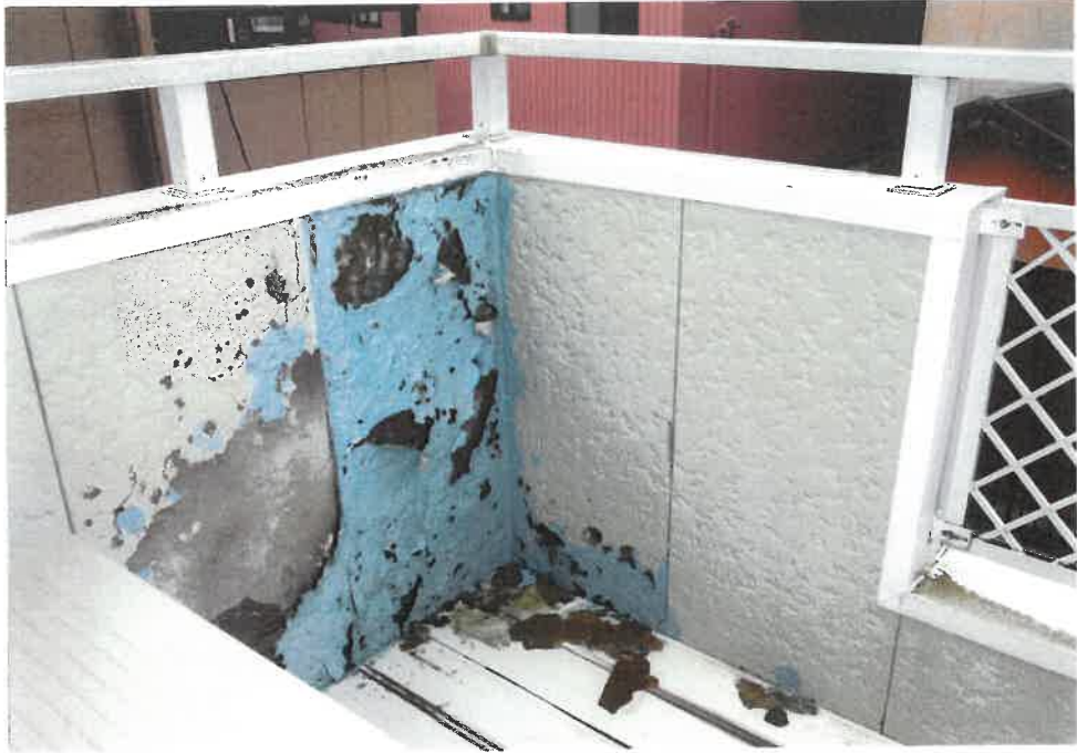
⑨ 壁面の腐食状況
