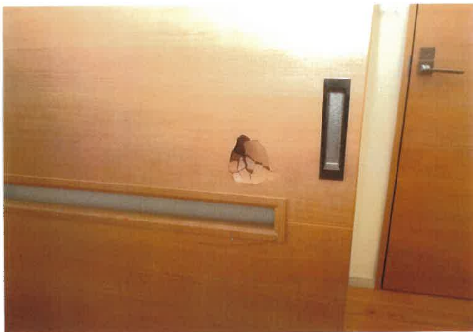
⑧ 引き戸の損傷状況
