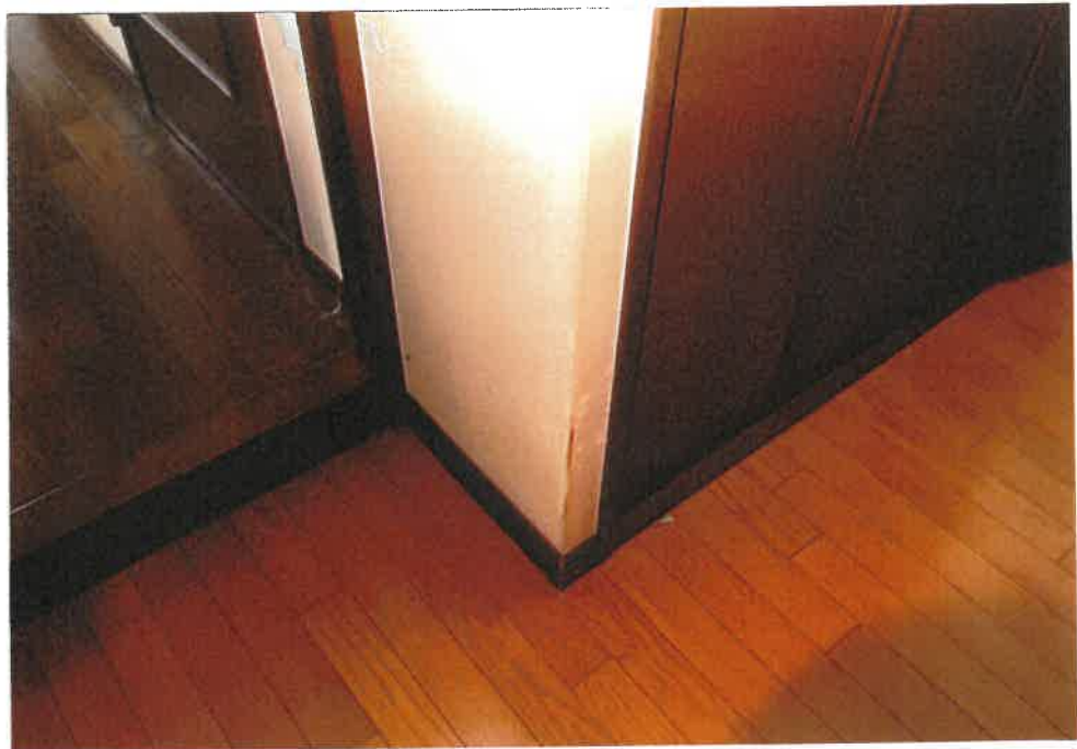
⑥ 壁面の損傷状況
