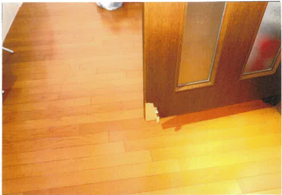
⑩ 開き戸の表面材の剥離箇所
