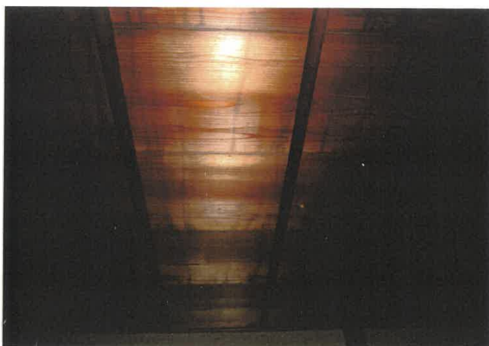
⑩屋内の状況 和室 3 の天井 の状況 (物件 4) (主である 建物)
