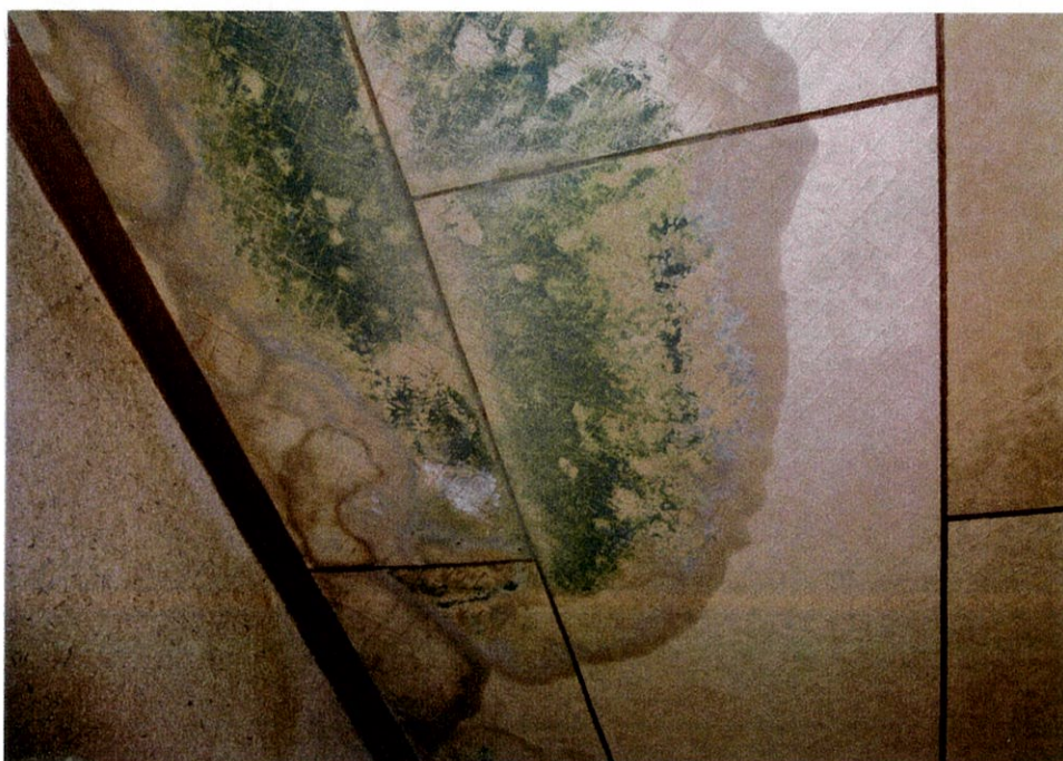
⑧屋内の状況 和室5の天井 の状況 (符号1の 附属建物)
