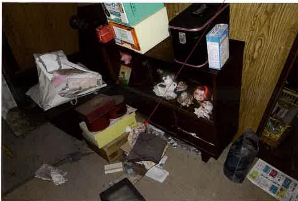
物件 4 建物室内(和室 2 の床が抜けている)
