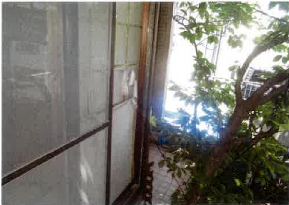
ガラスが割れて窓枠しか残っていない状況
