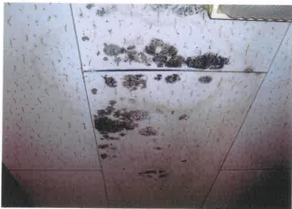
⑧屋内の状況 DKの天井の 状況 (物件 2)
