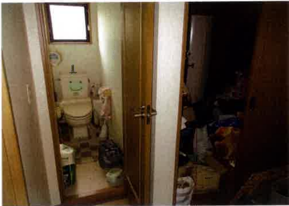
納戸に設置してある電気温水器
