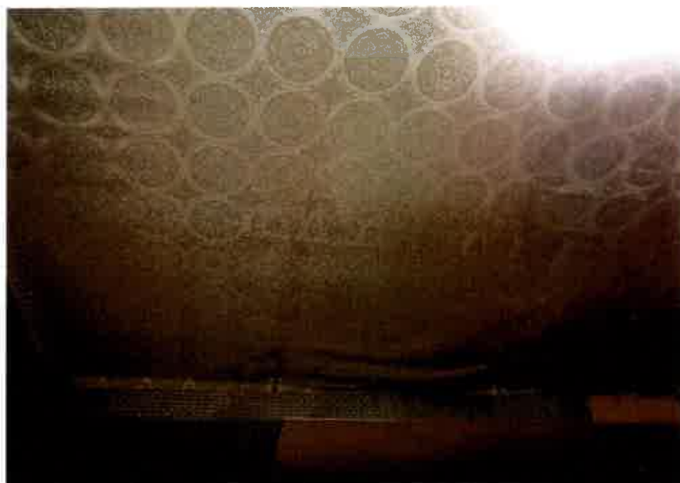
⑥屋内の状況 洋室2の天井 の状況
