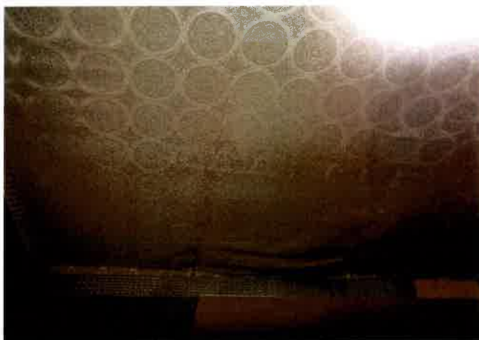
⑥屋内の状況 洋室2の天井 の状況
