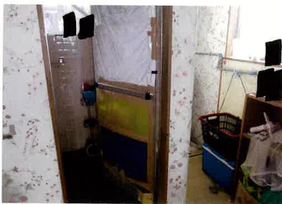
⑥屋内の状況 浴室の扉の 状況
