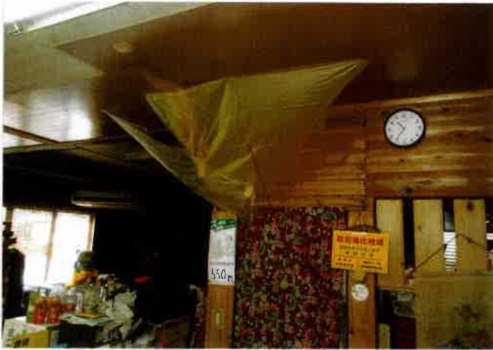
屋内の状況 (店舗2) 雨漏りによる天井の損傷の状況
