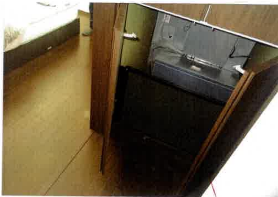
屋内の状況（2階 洋室1（ウォークインクローゼット内の全館空調用機械室内部））
