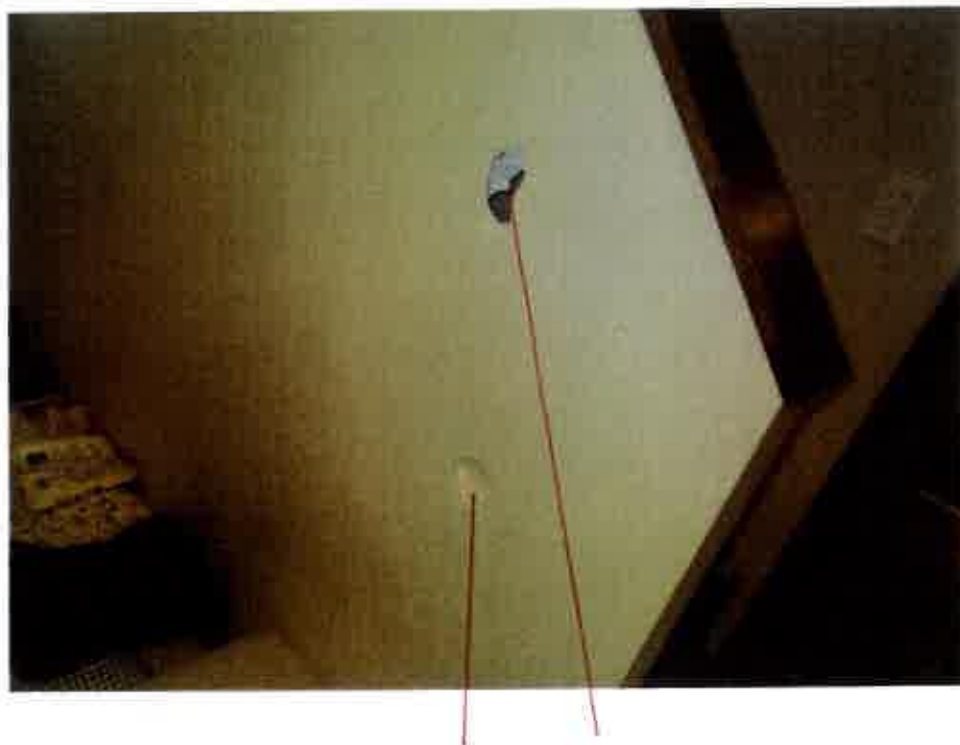
階段の壁のクロスの損傷の状況(穴)
