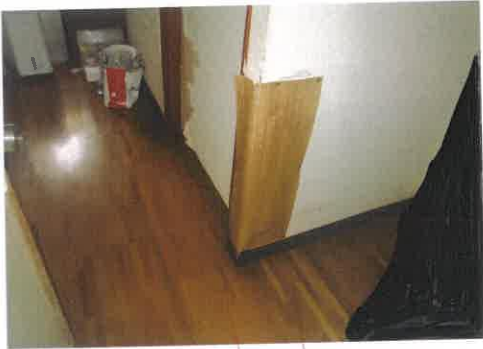
屋内の状況（2階 損傷の状況）
