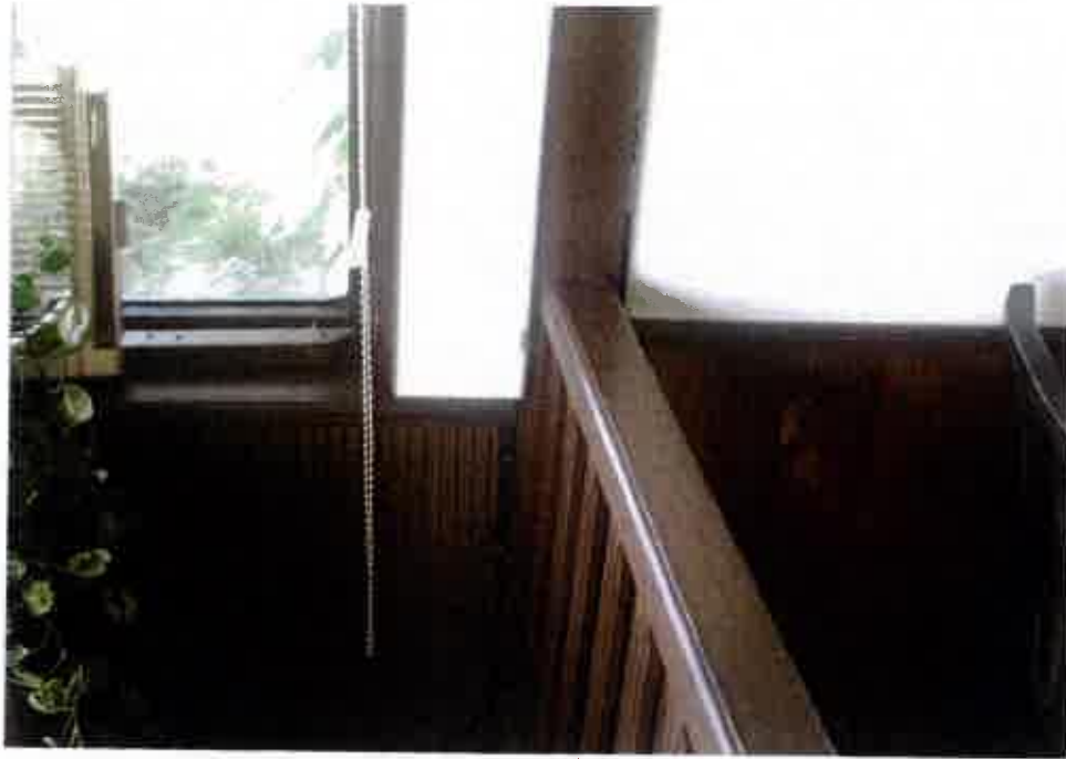
客席4の床面が南側(豊川河川敷方向)に傾斜しているため西側壁面に損傷(隙間)が生じている様子 屋内の状況(客席4)
