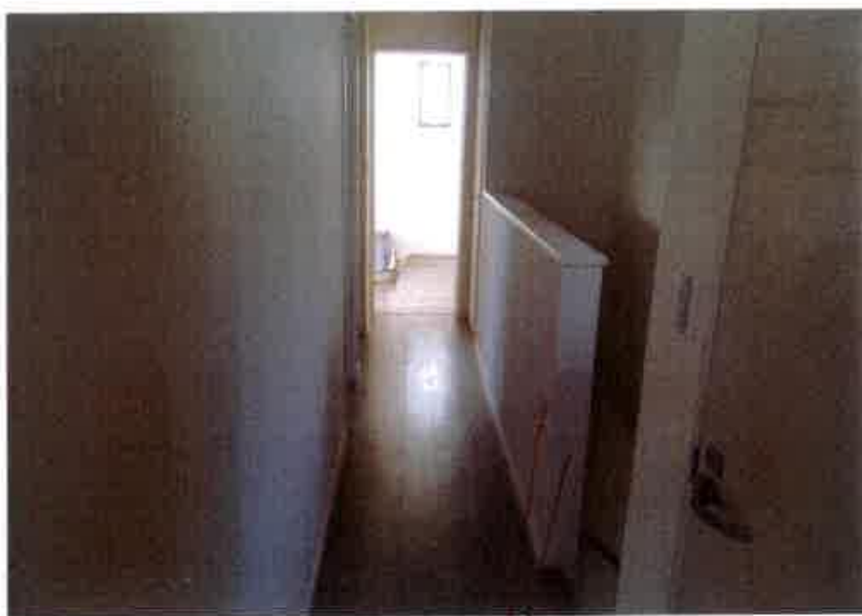
屋内の状況（2階 階段の壁面の損傷の跡）
