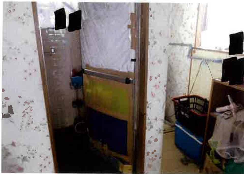
⑥屋内の状況 浴室の扉の 状況
