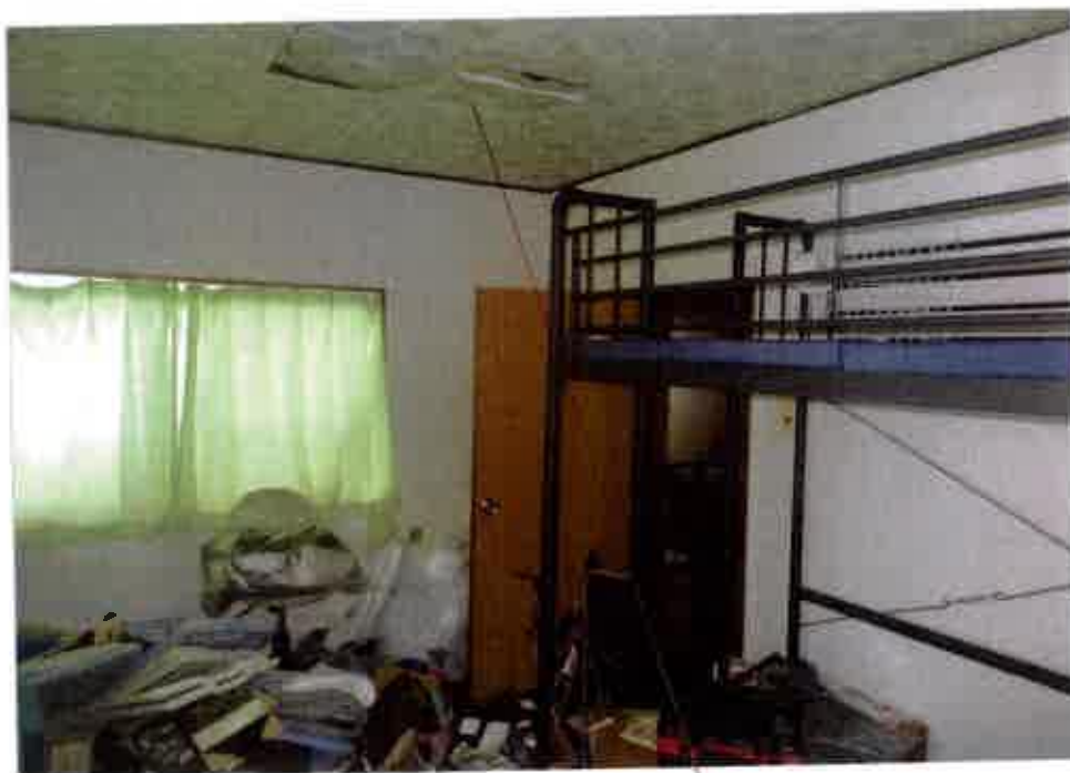
雨漏りの影響により天井が損傷及び汚損した状況 屋内の状況（2階 洋室2）
