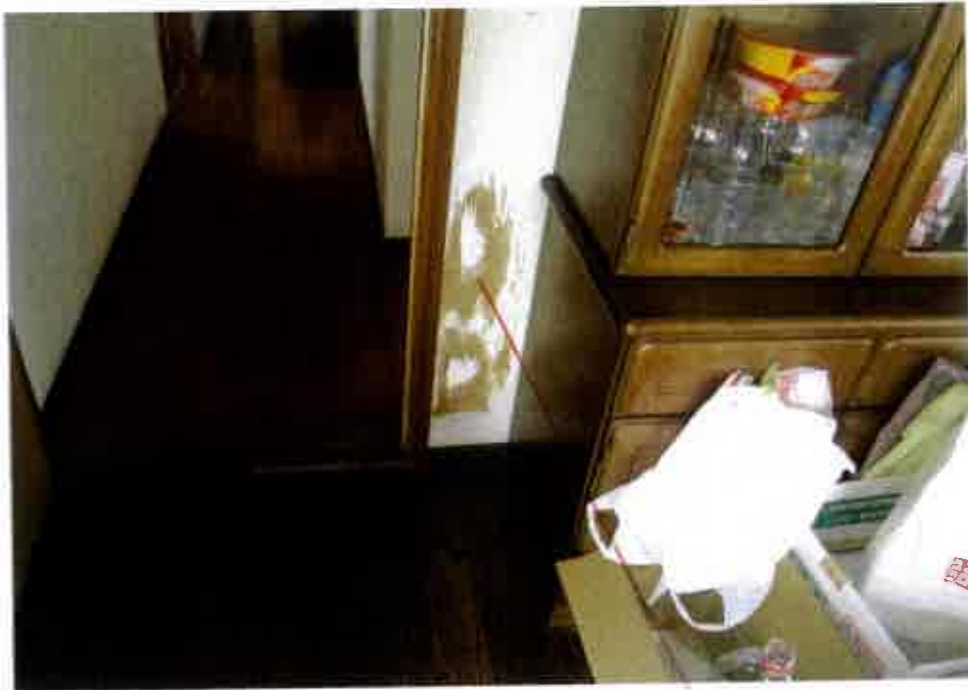
屋内の状況 (2階 ダイニングキッチン 壁面の損傷の状況)
