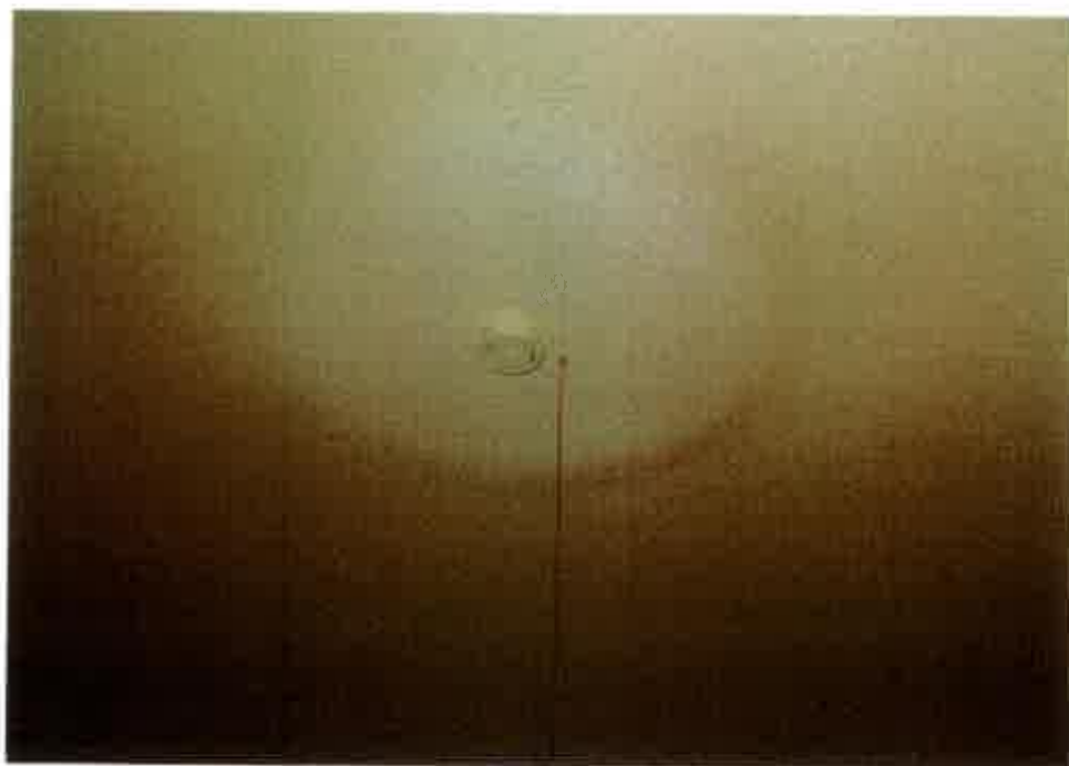
雨漏りの跡と思われる部分
