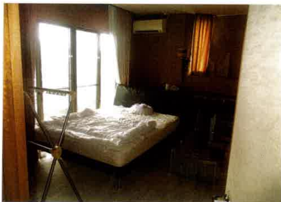
壁のクロスの破損の状況
