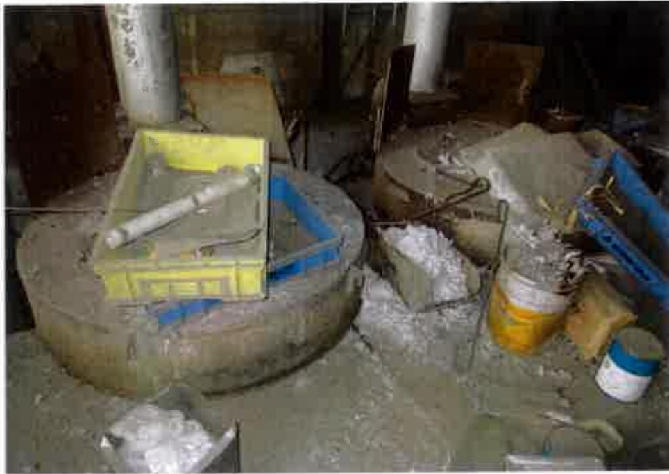
屋内の状況（物件 5 建物 工場 1 北側に設置してある溶融炉）
