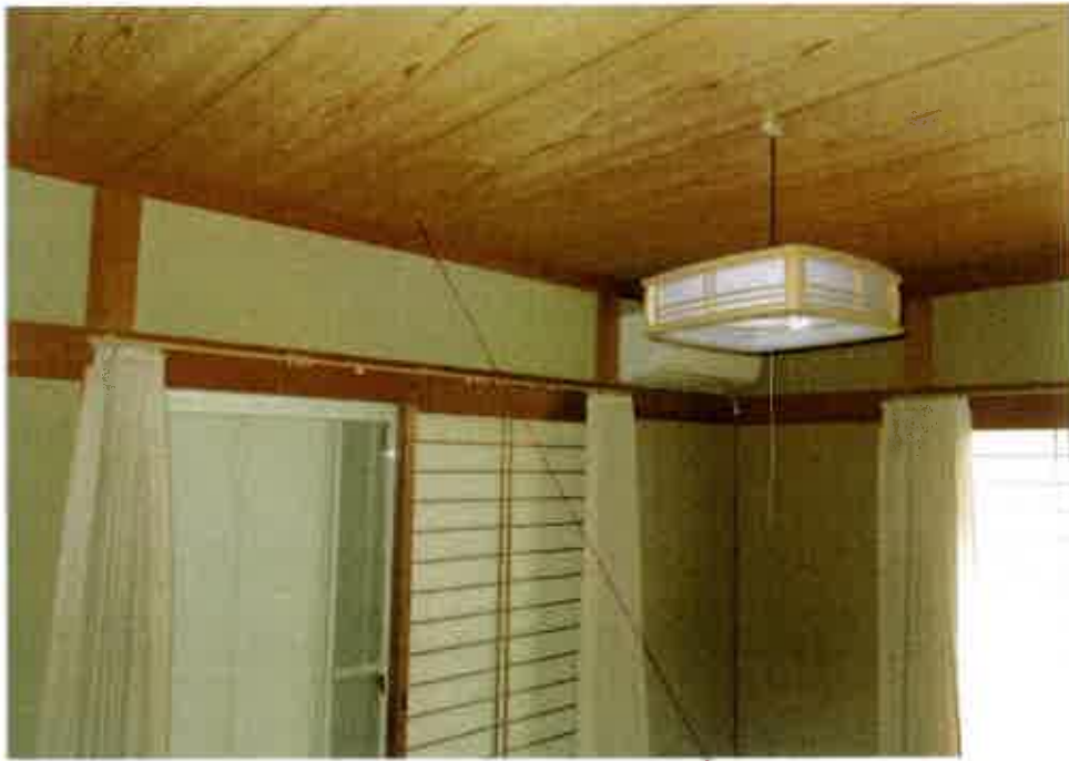
屋外の状況（1階 和室（天井の汚損の状況））
