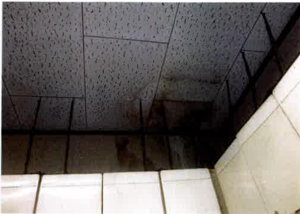
⑦屋内の状況 台所・食堂の 天井の状況
