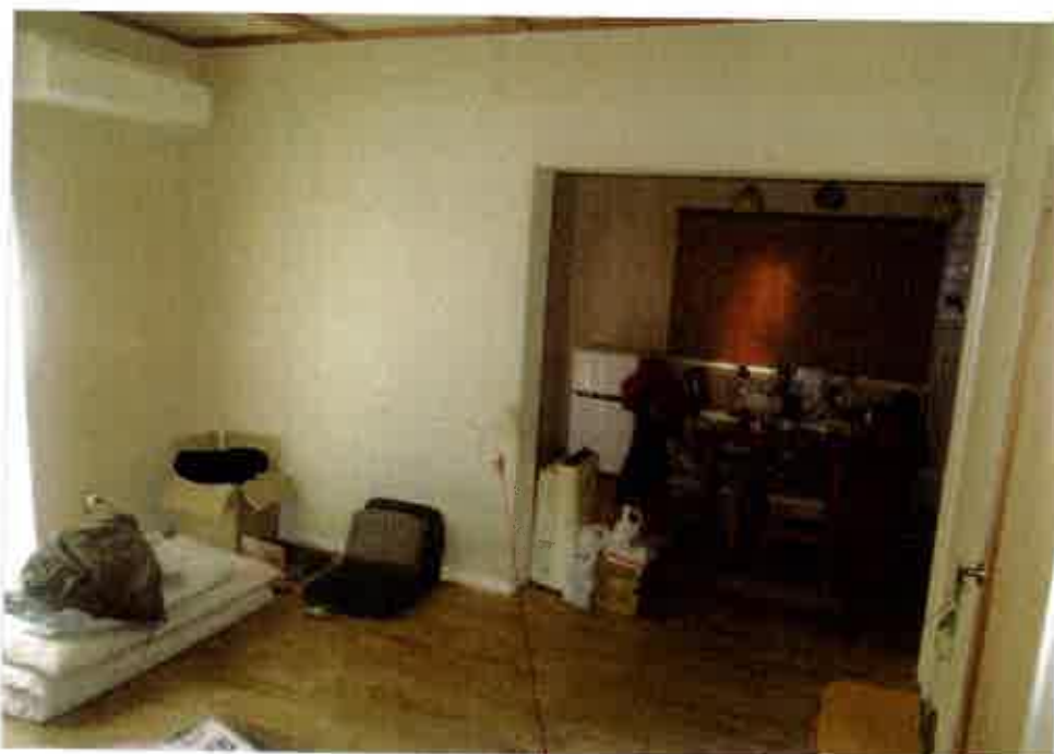
壁面の損傷の状況
