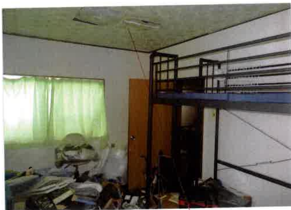
雨漏りの影響により天井が損傷及び汚損した状況
