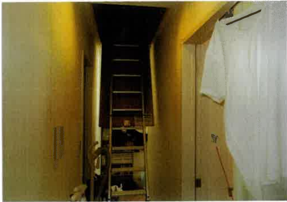
洋室3 (壁面損傷の跡)
