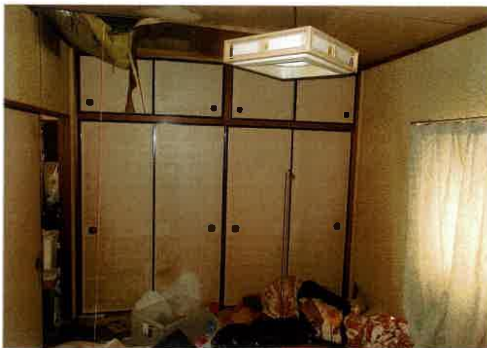
天井の天板が崩落した状況
