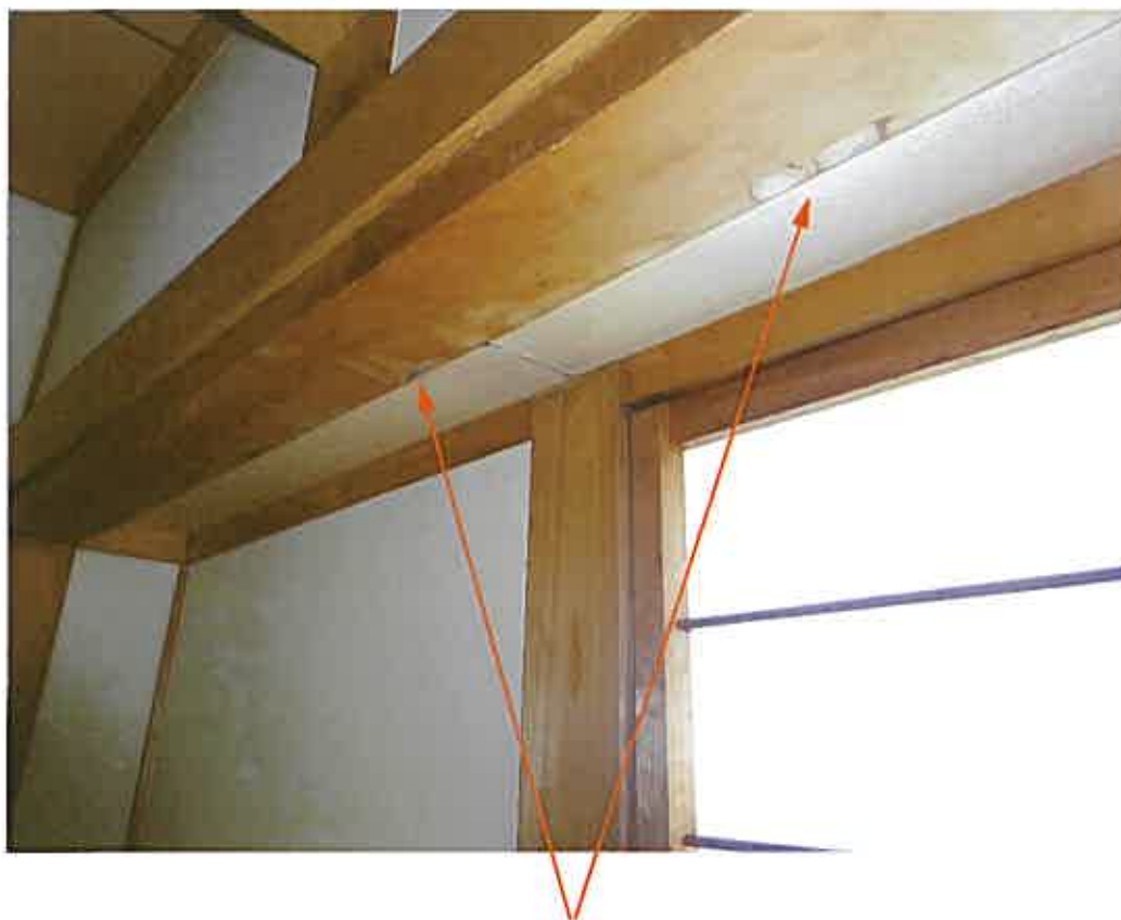
関係人が指示した雨漏りの痕跡と思われる箇所
