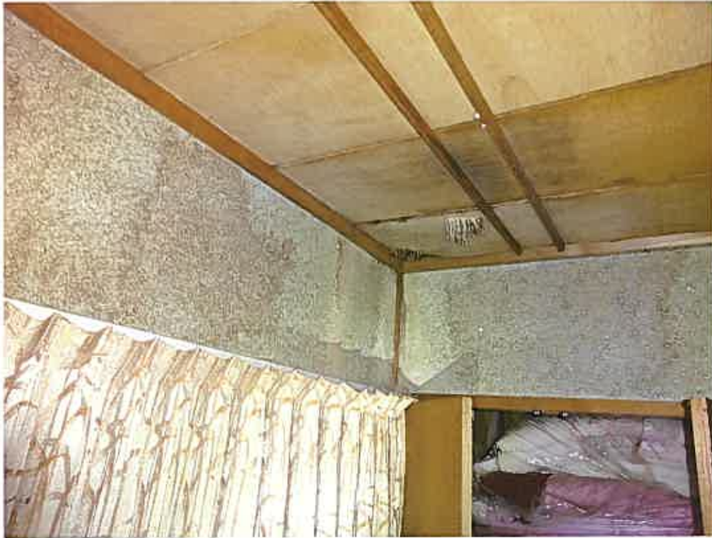
天井部や壁の 雨漏りの痕跡
