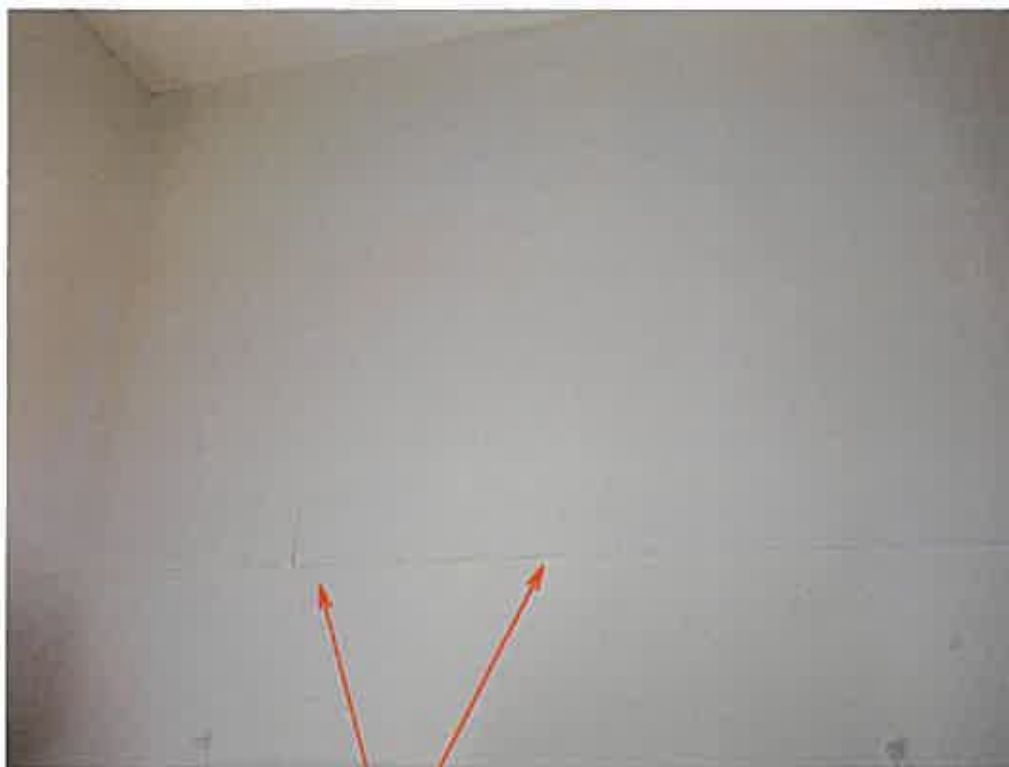
壁クロスのはび割れ
