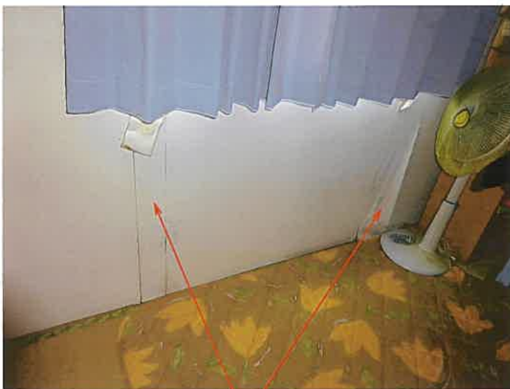
壁クロスの傷み
