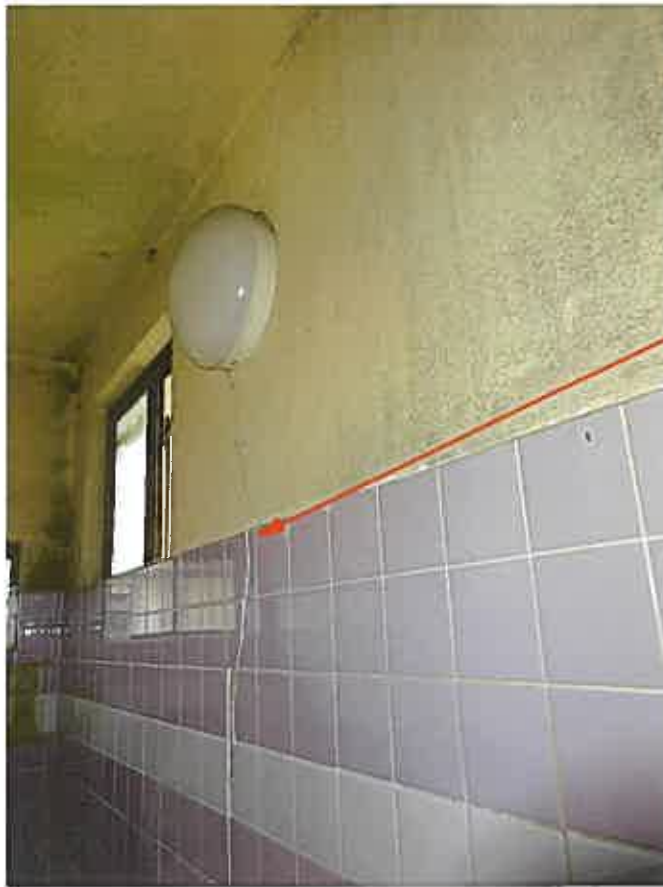
トイレ壁面のクラック
