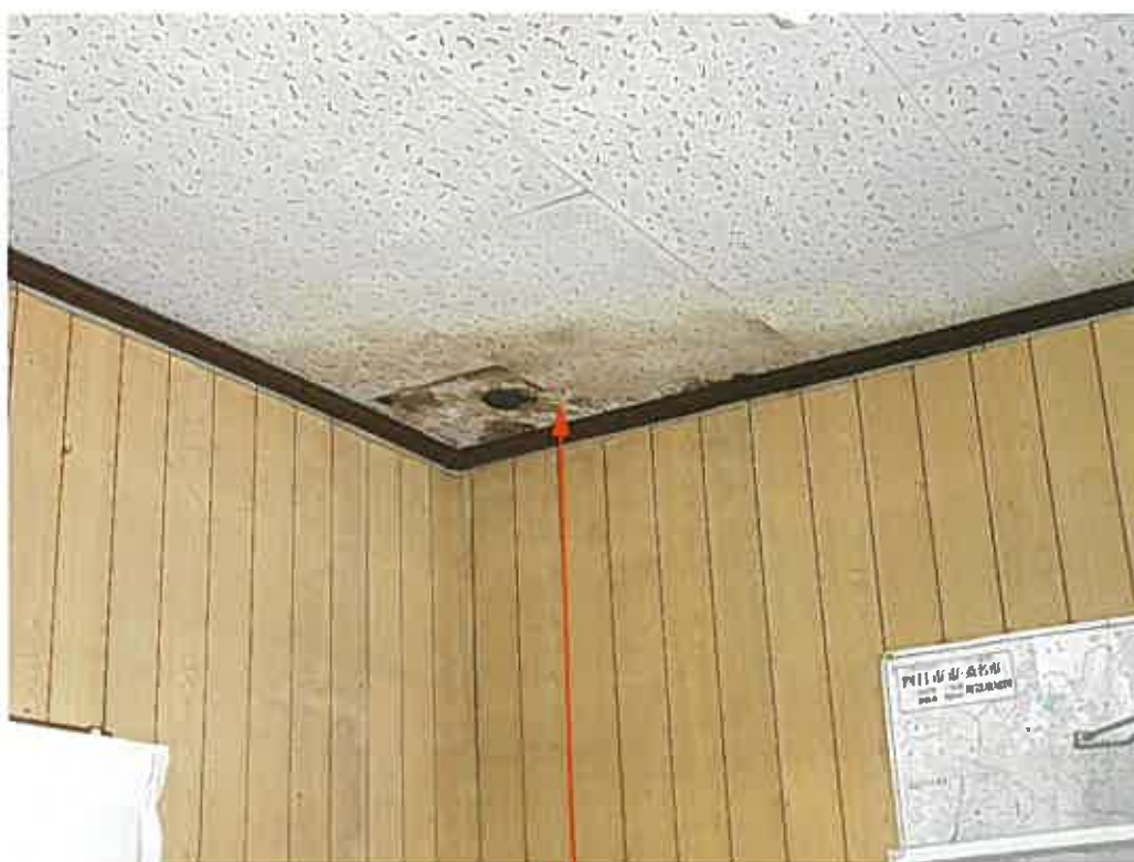
雨漏りによると思われるシミ
