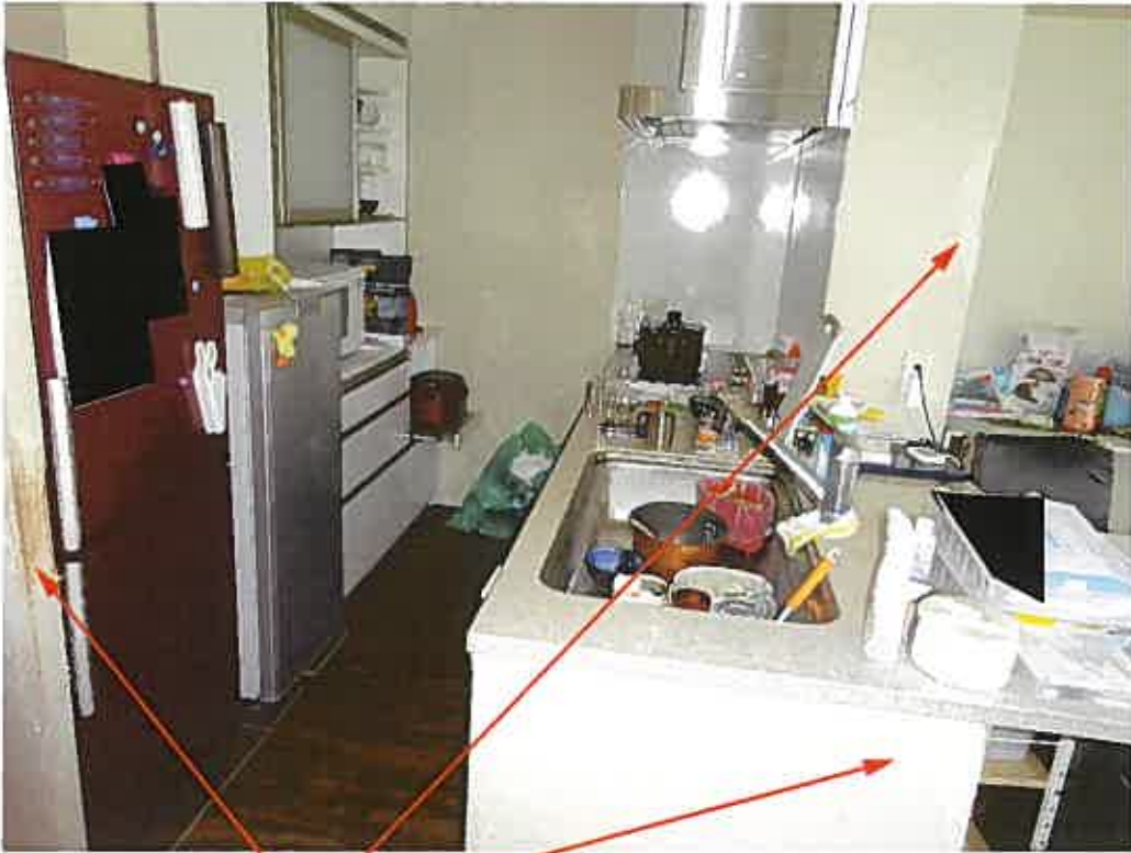
壁面等の傷み
