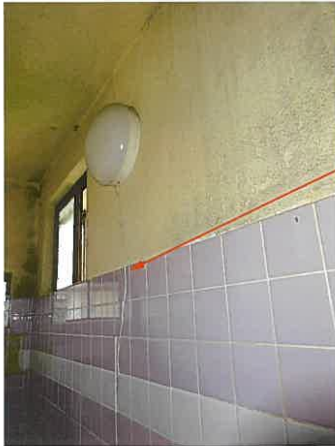
トイレ壁面のクラック
