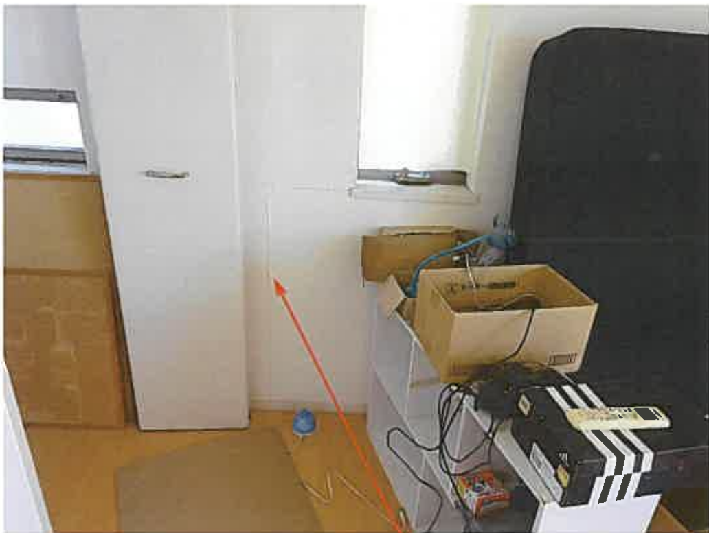
壁クロスの亀裂
